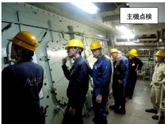
【写真4】銀河丸（機関室）
